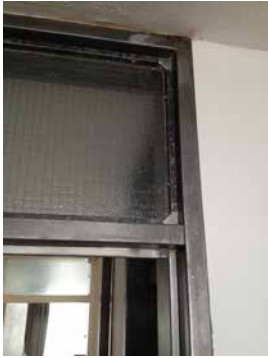
11. Fanlight above door frame - HTL 2015
